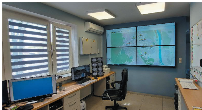
Fot. 2. Centrum Nadzoru Ruchu – stanowisko pracy dyspozytora Źródło: fot. R. Woźniak
