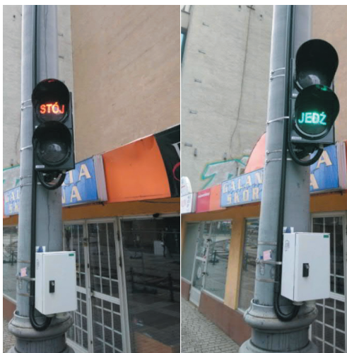
Fot. 5. Sygnalizatory wjazdowe Źródło: zdjęcie własne
